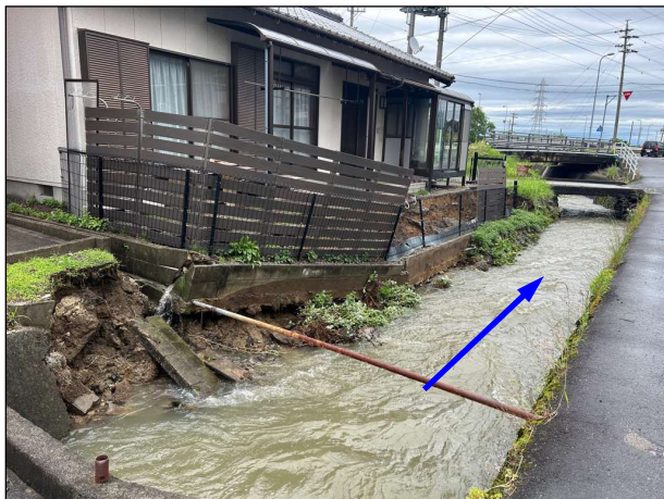
普通河川小池川（被災状況）
