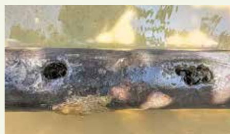
実際に本市で漏水事故が発生した水道管。 腐食が進み穴が開いています
