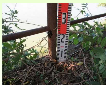
図6 損傷の主な事例
