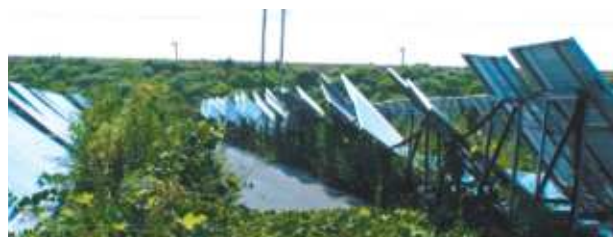
□適正に管理されていない太陽光発電設備 写真提供：(一社)構造耐力評価機構
