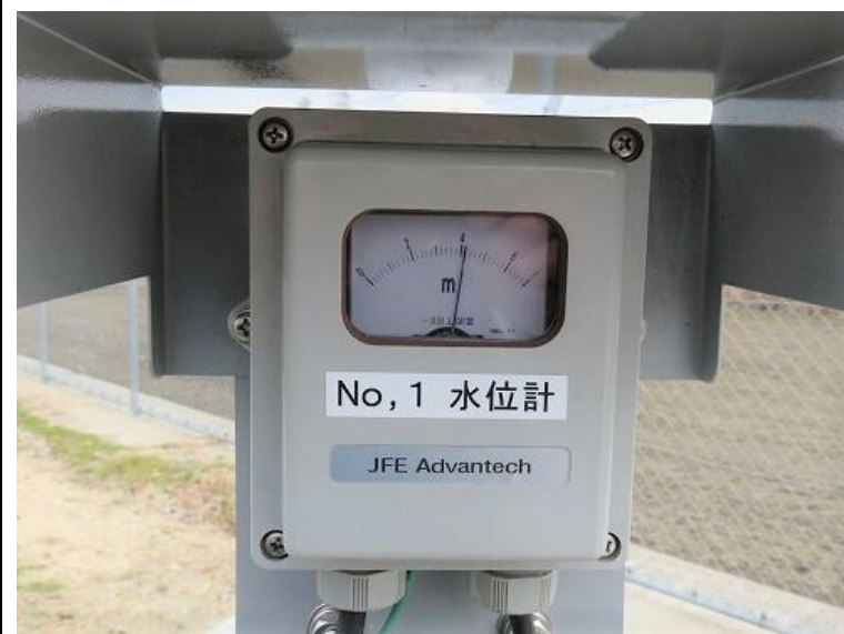
写真5 No.1 取水ポンプ水位計
