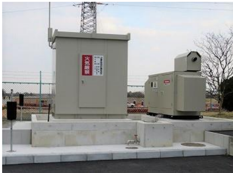
写真 11 自家発電装置
