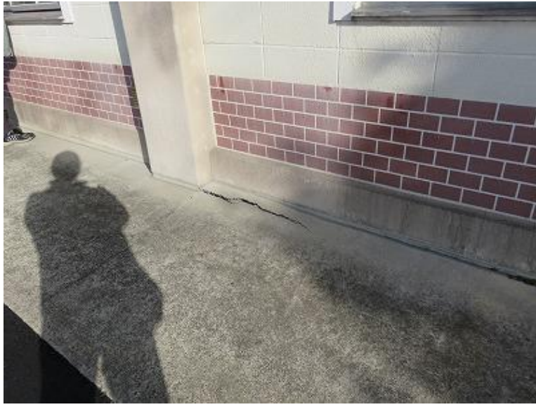
写真19 既設ポンプ所の目地開き
