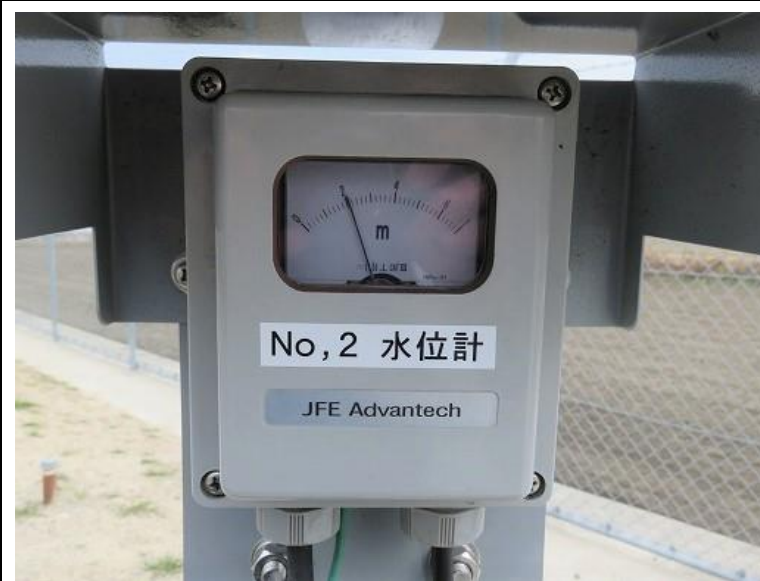
写真6 No.2 取水ポンプ水位計
