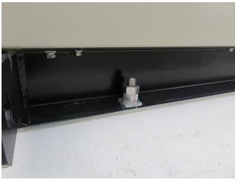
写真 16 自家発電装置据付ボルト ステンレス鋼製でダブルナットを使用
