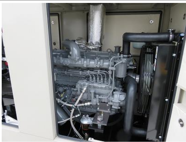
写真 12 自家発電装置用ディーゼルエンジン
