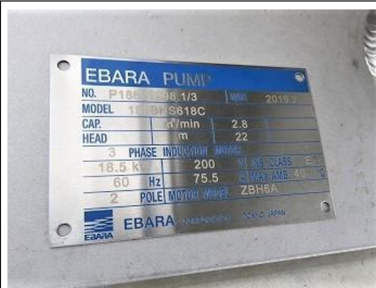
写真4 取水ポンプ銘版
