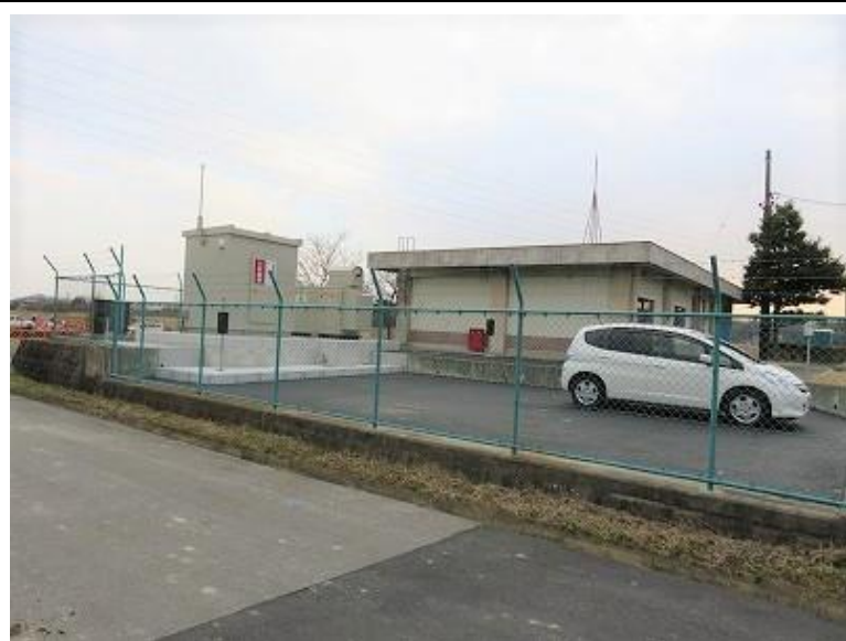
写真1 ポンプ所（建屋は既設） ポンプ所の左側は今回工事で新設された自家発電装置
