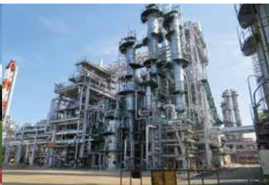
増設したプラント設備 (企業立地奨励金交付事業)
