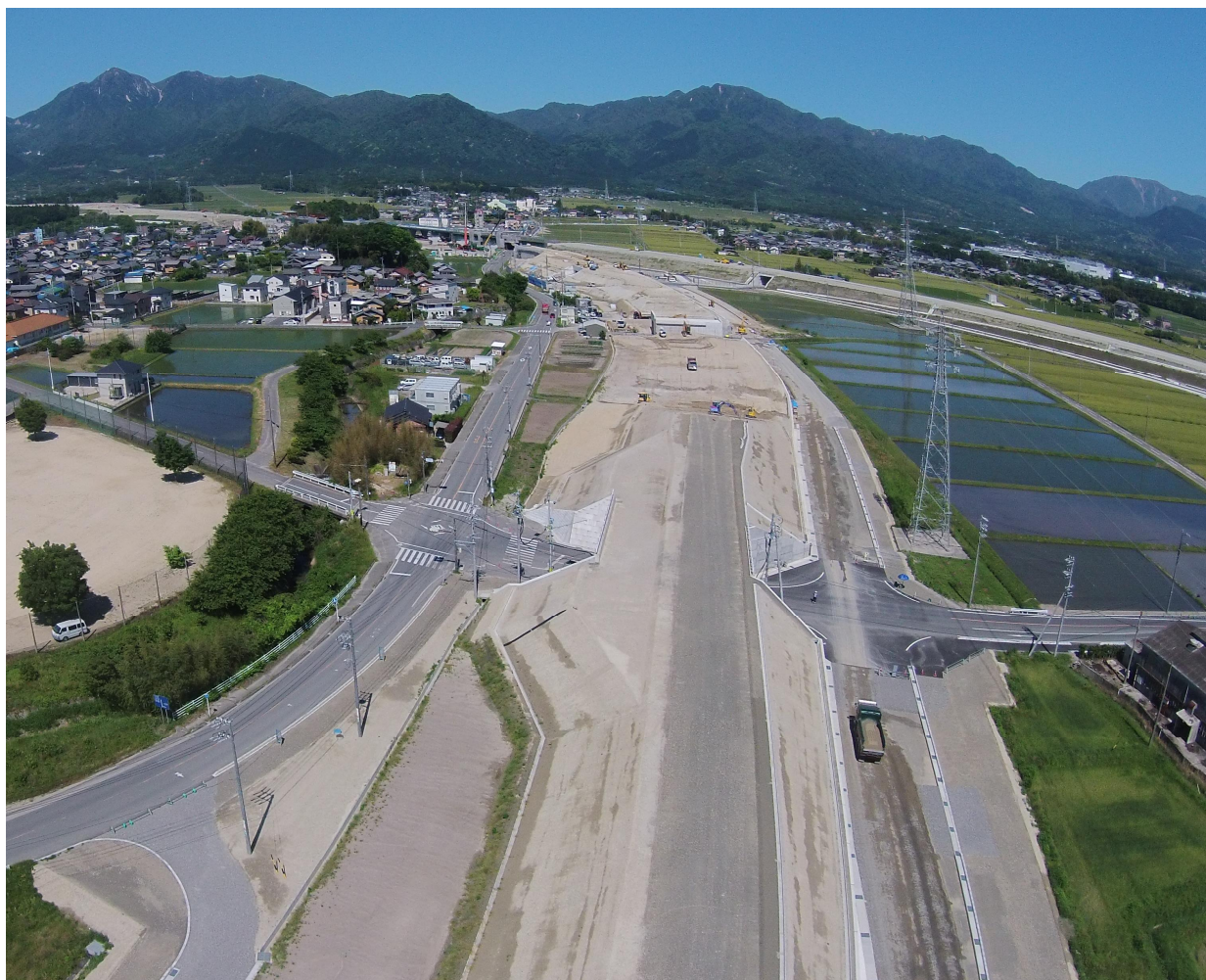
工事が進む四日市湯の山道路から新名神高速道路・菰野IC方面を望む
