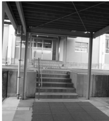
< 校舎と特別教室棟との段差 >
