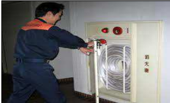
屋内消火栓設備
