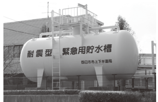
耐震型の緊急用貯水槽
