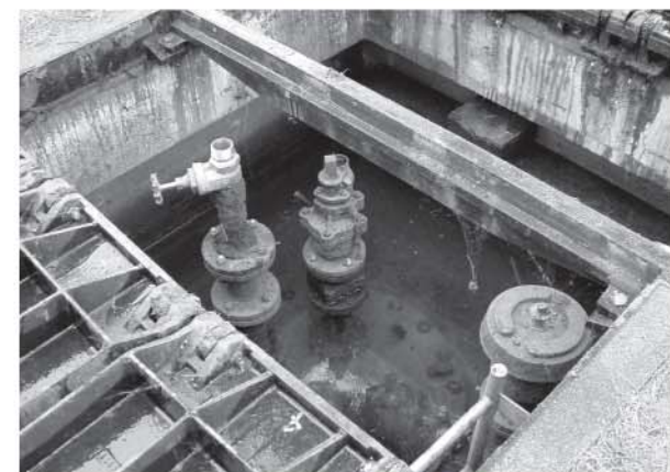
耐震型緊急用貯水槽
