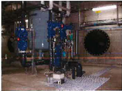
雨水再利用設備 (砂ろ過装置)
