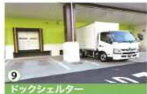
9 ドックシェルター 配送搬入場所にドックシェルターを設置し、虫等の侵入を防ぎます。
