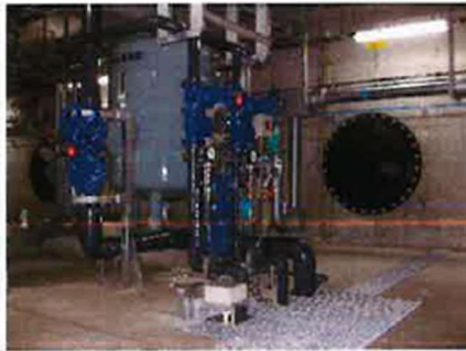
雨水再利用設備 (砂ろ過装置)
