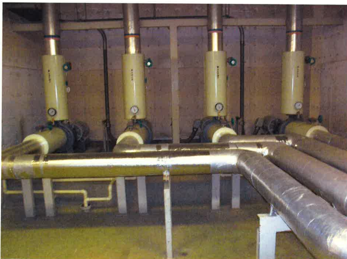
②冷温水ポンプ
