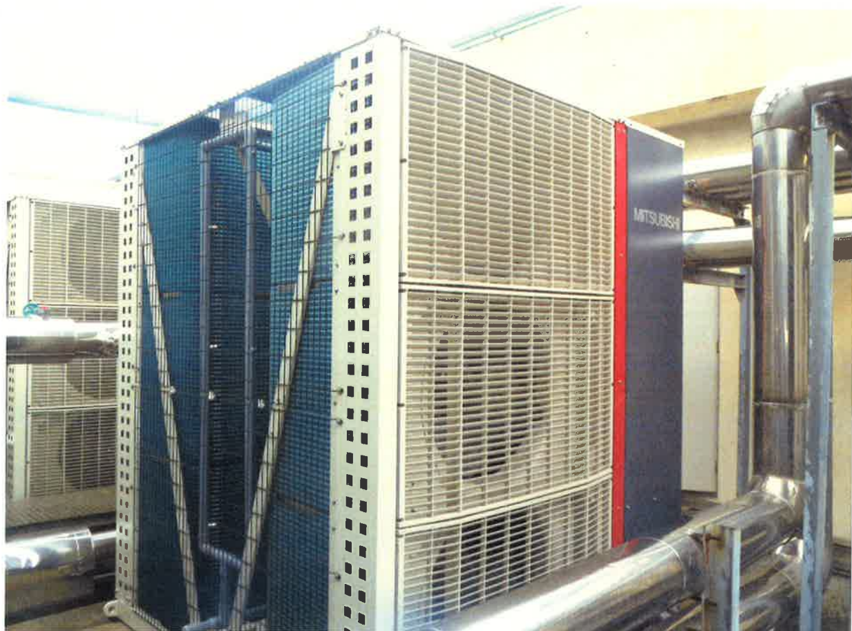
②空調用チラーユニット
