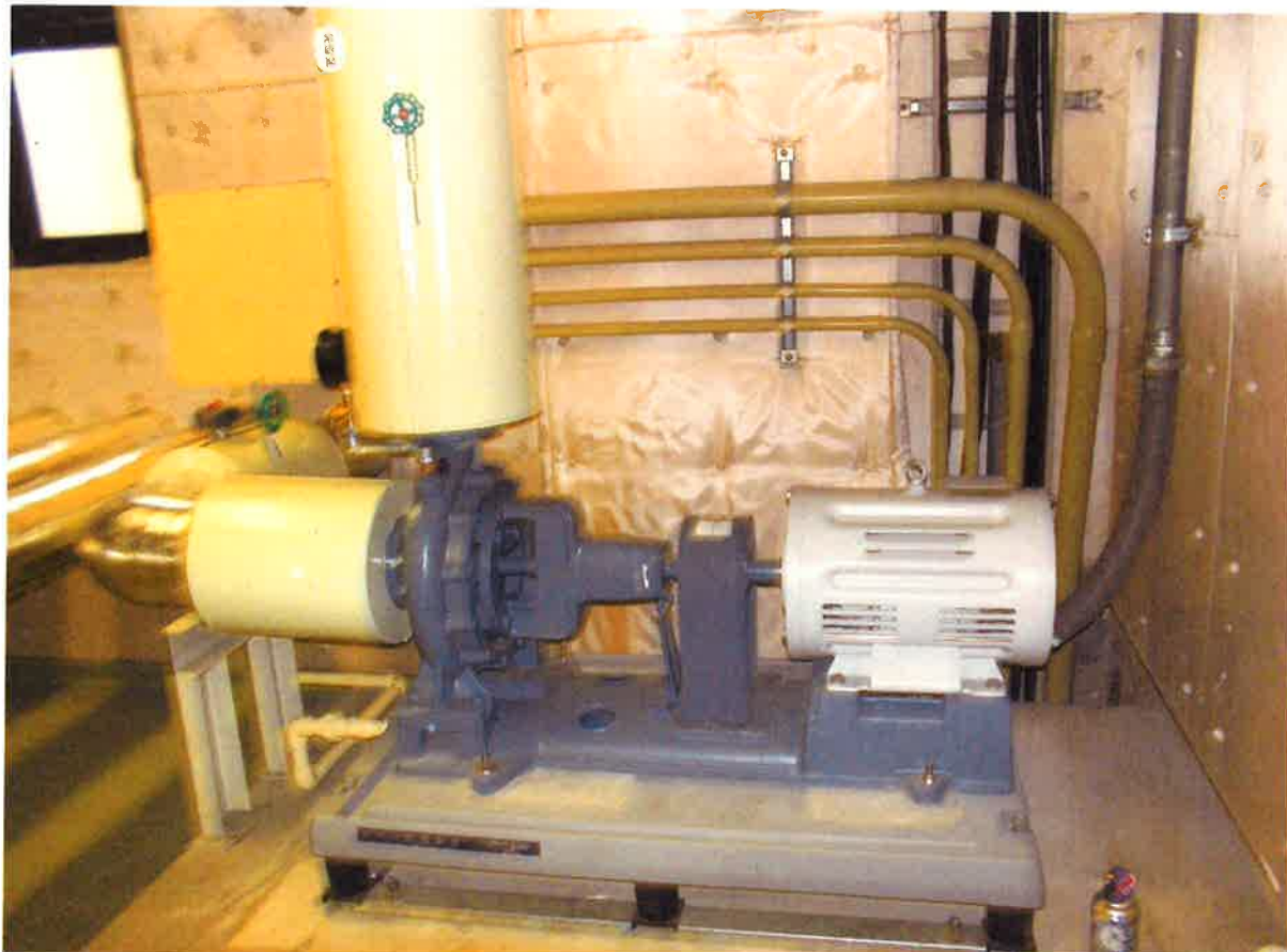
①冷温水ポンプ
