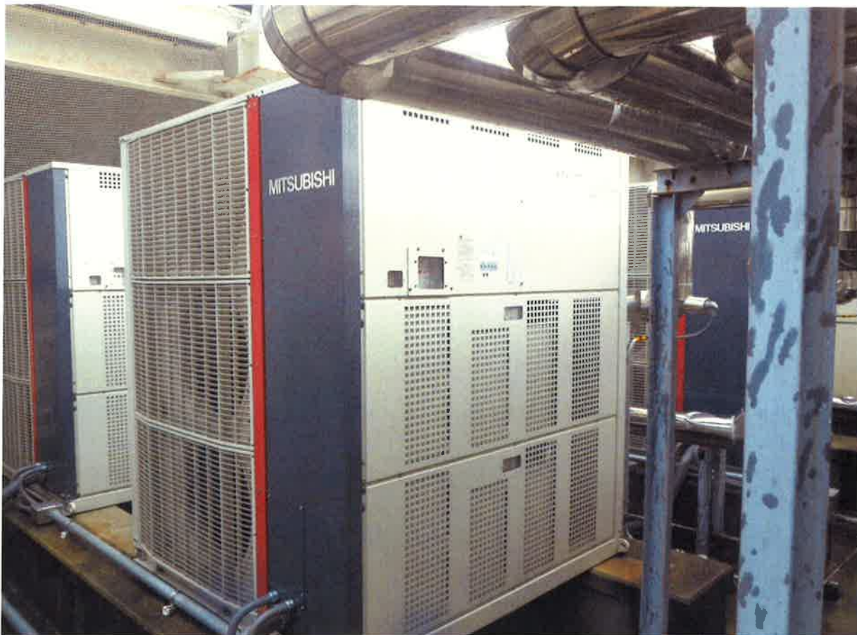
①空調用チラーユニット
