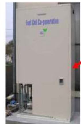
水素燃料電池
