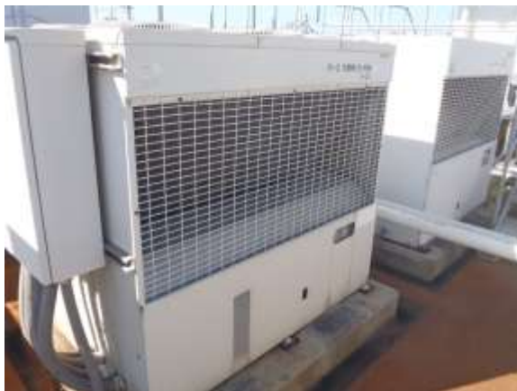
6号冷蔵庫 冷凍機
