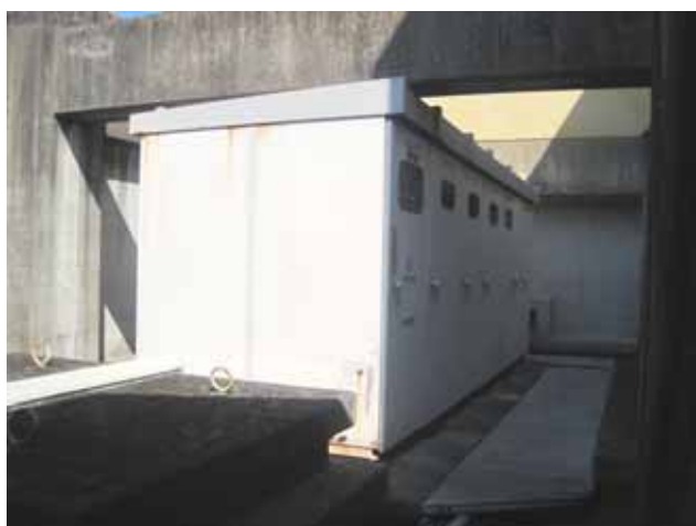
高圧受変電設備(キュービクル)
