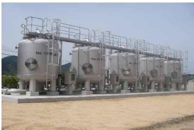
参考 萩市 除マンガン処理施設
