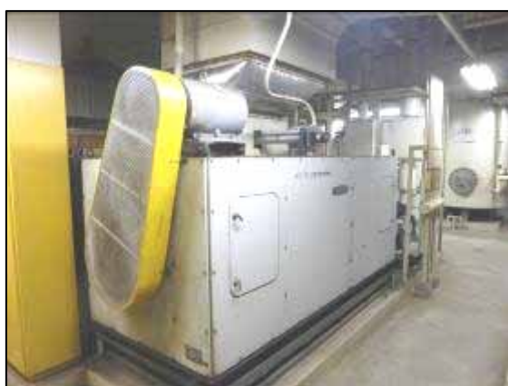
消防本部・中消防署エアハンドリングユニット
