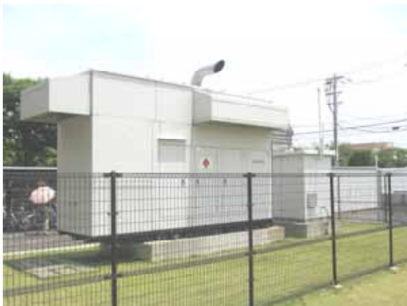
市庁舎東側発電機
