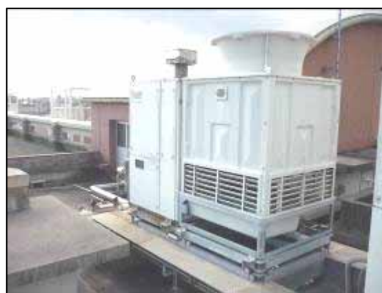
北消防署冷温水発生機
