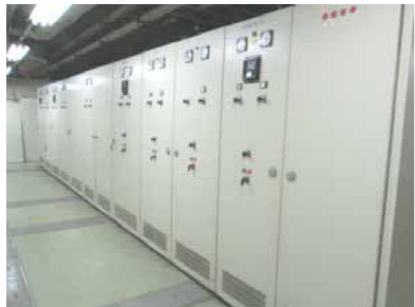
総合会館地下 1 階キュービクル（受変電設備）
