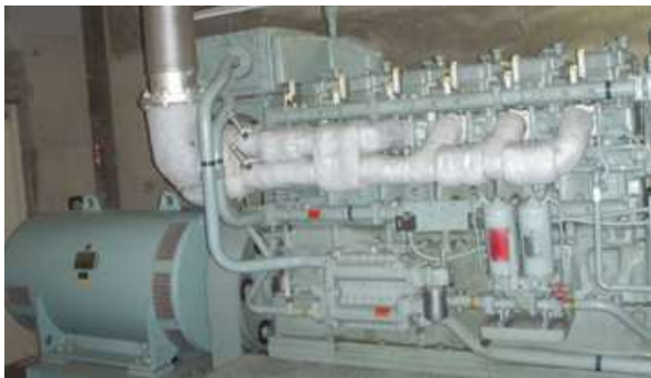
非常用発電機
