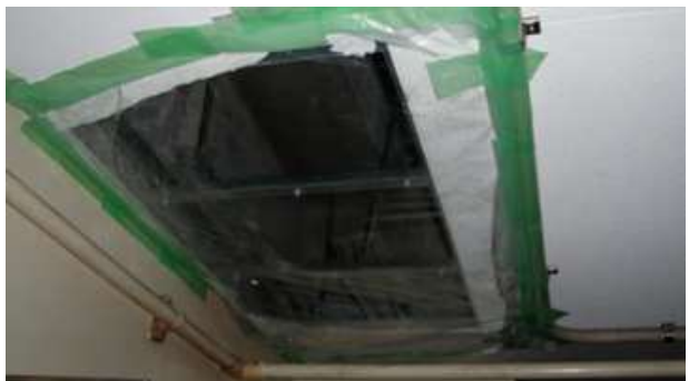
屋根裏配管漏水
