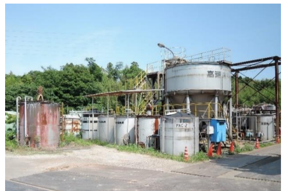
北部埋立処分場浸出水処理施設
