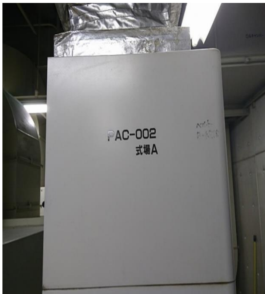
ダクト式室内機(式場)
