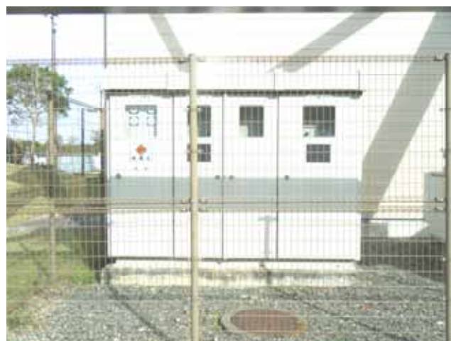
(楠中央緑地：電気施設)
