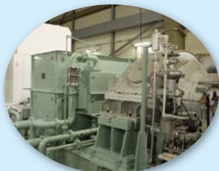
蒸気タービン 発電機
