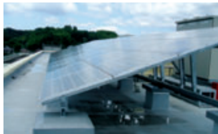
校舎屋上の太陽光発電
