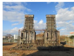
旧富洲原町上水道大矢知水源地（濾過機器）
